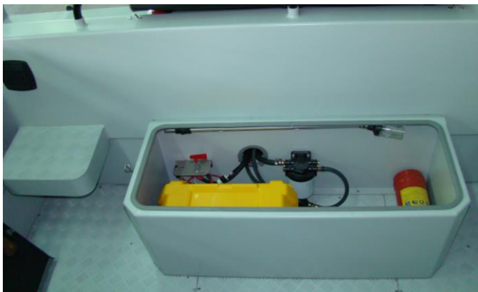
Кормовой рундук с установленным оборудованием (аккумулятор, топливный фильтр, огнетушитель, ключ массы, съемный ходовой огонь)
